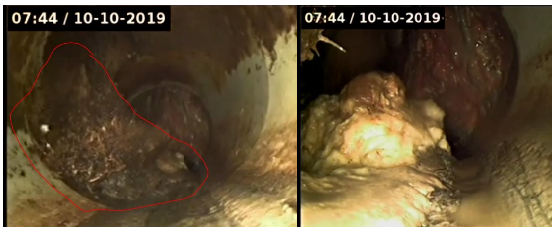
Rotgenomträngning i spillvattenledning
